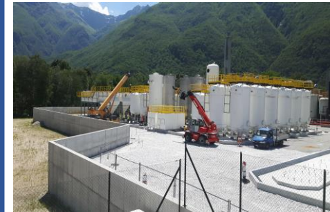
Impianto di trattamento delle acque di falda
